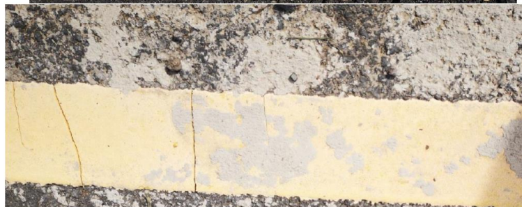
Figura 44. Deterioros en la demarcación horizontal del proyecto. Fuente LanammeUCR,2020.
