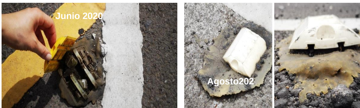
Figura 47. Condición de deterioro de captales y epóxico evidenciado en las visitas realizadas durante los meses de junio y agosto 2020. Fuente LanammeUCR,2020.
