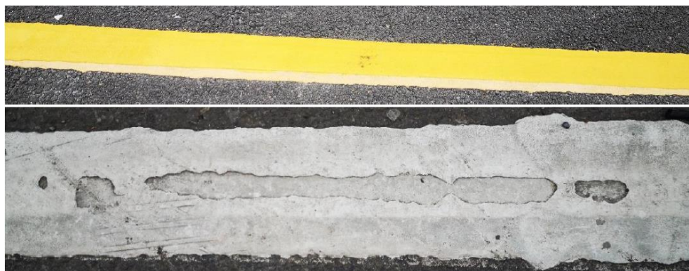
Figura 48. Demarcación nueva sobre demarcación anterior. Fuente LanammeUCR,2020.
