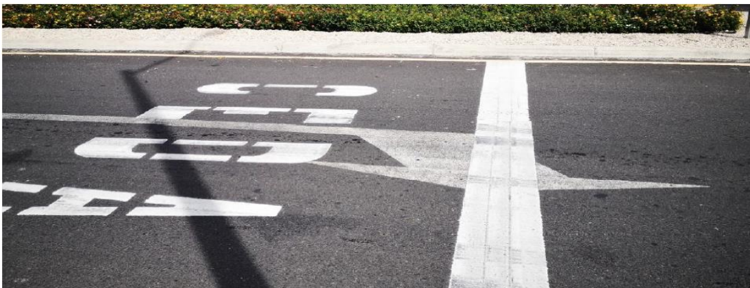
Figura 45. Demarcación nueva sobre demarcación antigua, junio 2020. Fuente LanammeUCR,2020.
