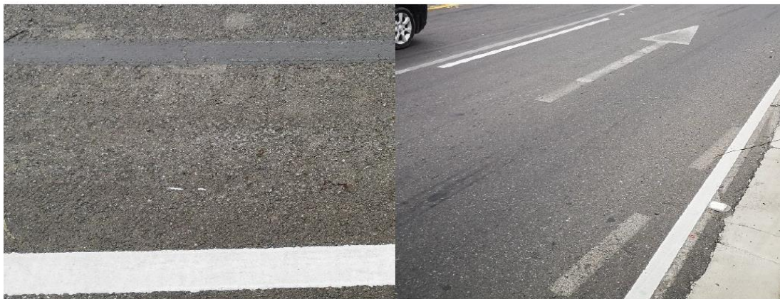
Figura 46. Borrado deficiente de la demarcación agosto 2020. Fuente LanammeUCR,2020.
